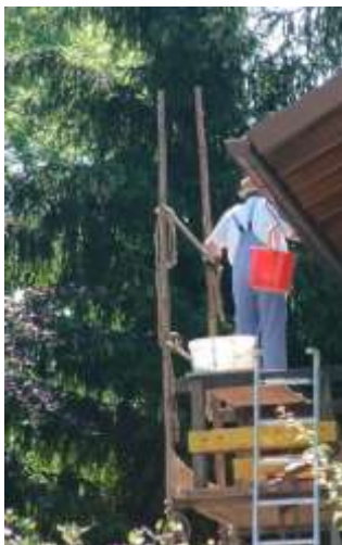
00286a.jpg: Dacharbeiten ohne ein ordnungsgemäßes Gerüst oder Absturzsicherungen sind lebensgefährlich.
