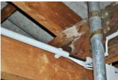
00420.jpg: Wenn die Dachwartung jahrelang vernachlässigt wird, können aus kleinen Mängeln kapitale Dachschäden werden.
