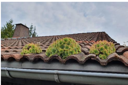
00639.jpg: So schön diese ungewollte „Dachbegrünung“ anzusehen ist: Der nächste Starkregen kann die Dachrinne und Fallrohre damit verstopfen.
