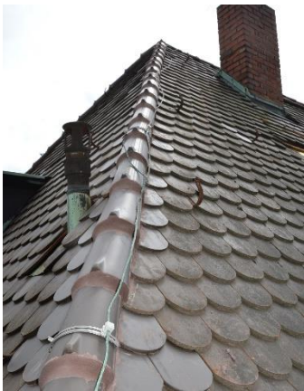
00640.jpg: Blitzschutz, Lüfterrohre und Kamineinfassungen haben hier ihre besten Zeiten schon hinter sich und stellen große Gefahrenquellen dar.
